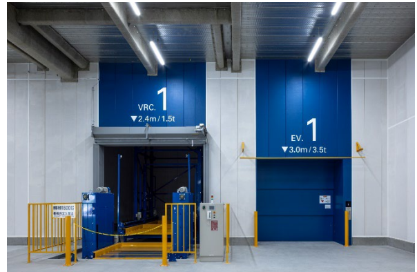
荷物用エレベーターと垂直搬送機
